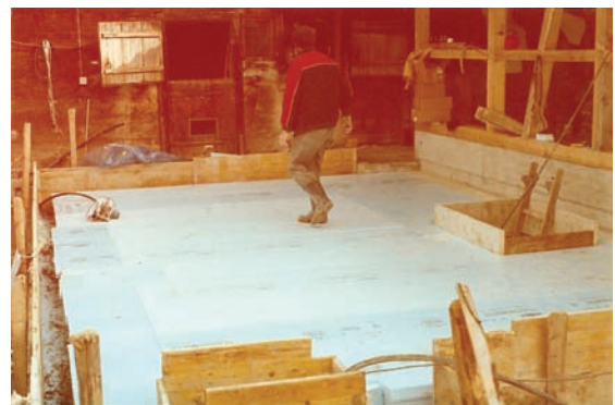
Isolieren geht doch besser wen es rechteckig ist. Anlage 1993
